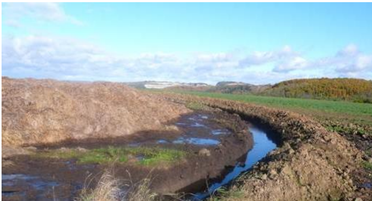
Foto: Zábrany odtoku hnojůvky ze složiště – příkop s navýšením terénu
